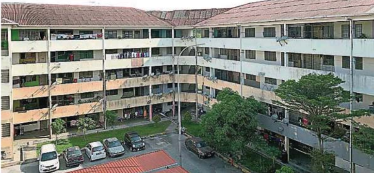
万挠彩虹花园全部3座组屋屋顶,因为长年受到强风吹袭而破损和漏水。
