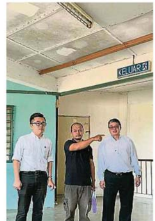
祖基里(中)向蔡伟杰(左)和梁自坚(右)诉说组屋因为漏水而在天花板留下许多发霉的印迹。
